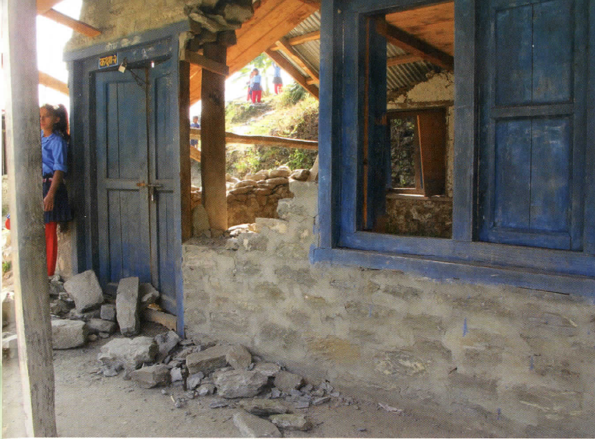
La scuola secondaria di Barkbugat lesionata dal terremoto (foto F. Poli)
